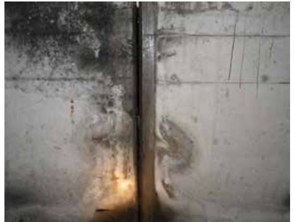
Raumfuge Außenwand mit Wasserdurchtritt
