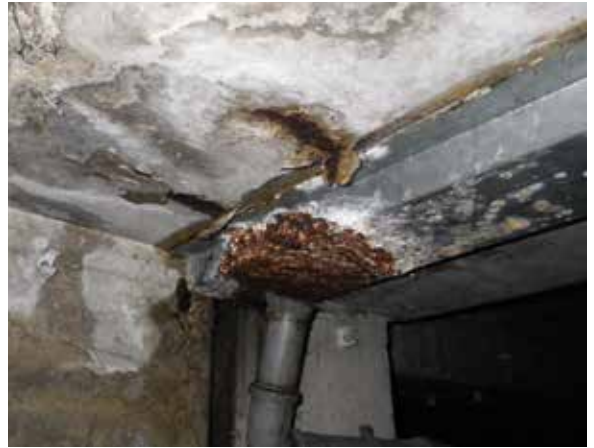
Raumfuge im Unterzug mit korrodierter Auffangkonstruktion und defekter Entwässerung
