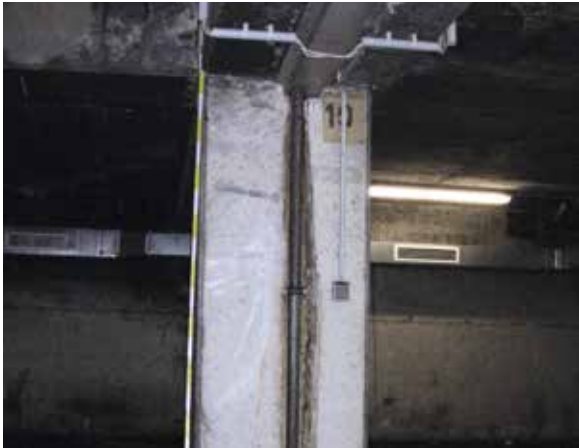
Raumfuge im Unterzug mit Auffangkonstruktion, defekte Entwässerung
