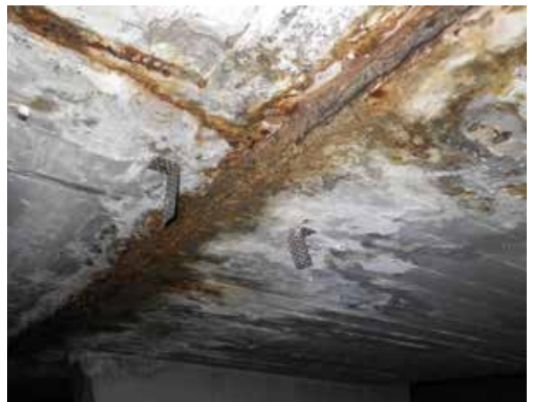
Raumfuge im Unterzug mit Wasserdurchtritt, Betonschäden
