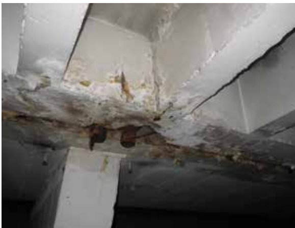
Raumfuge im Unterzug mit Wasserdurchtritt, Betonschäden
